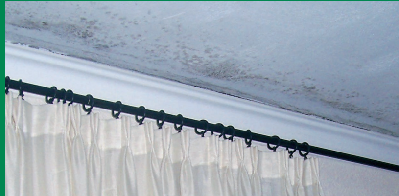
Condensvorming op koudebruggen (vb. plafondgedeelte aan de buitenmuurzijde) preventief behandelen om het risico op schimmelvorming te beperken.
